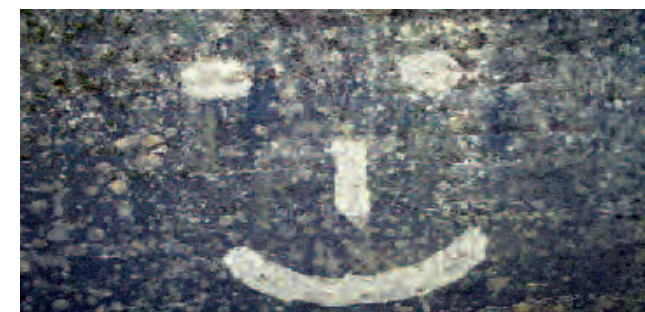
Kärcherspuren an einer Stützmauer auf der eigenen Strecke
