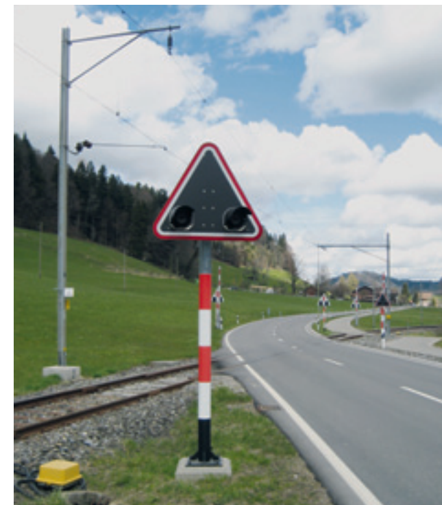
Die Bahnübergangsanlage über die Kantonsstrasse im Bussenthal wurde 1999 erbaut, als die Strecke noch den SBB gehörte
