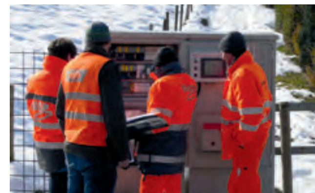
Ohne Strom und Elektronik läuft hier nichts.
