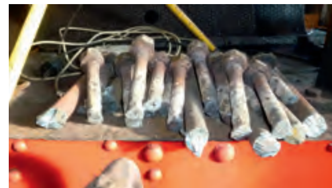
Zähne ziehen: Diese Verankerungen taugten nichts mehr.
