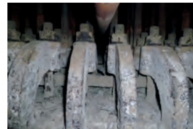
Wo man sonst nie hinsieht: Die Deckenanker über der Feuerbüchse.
